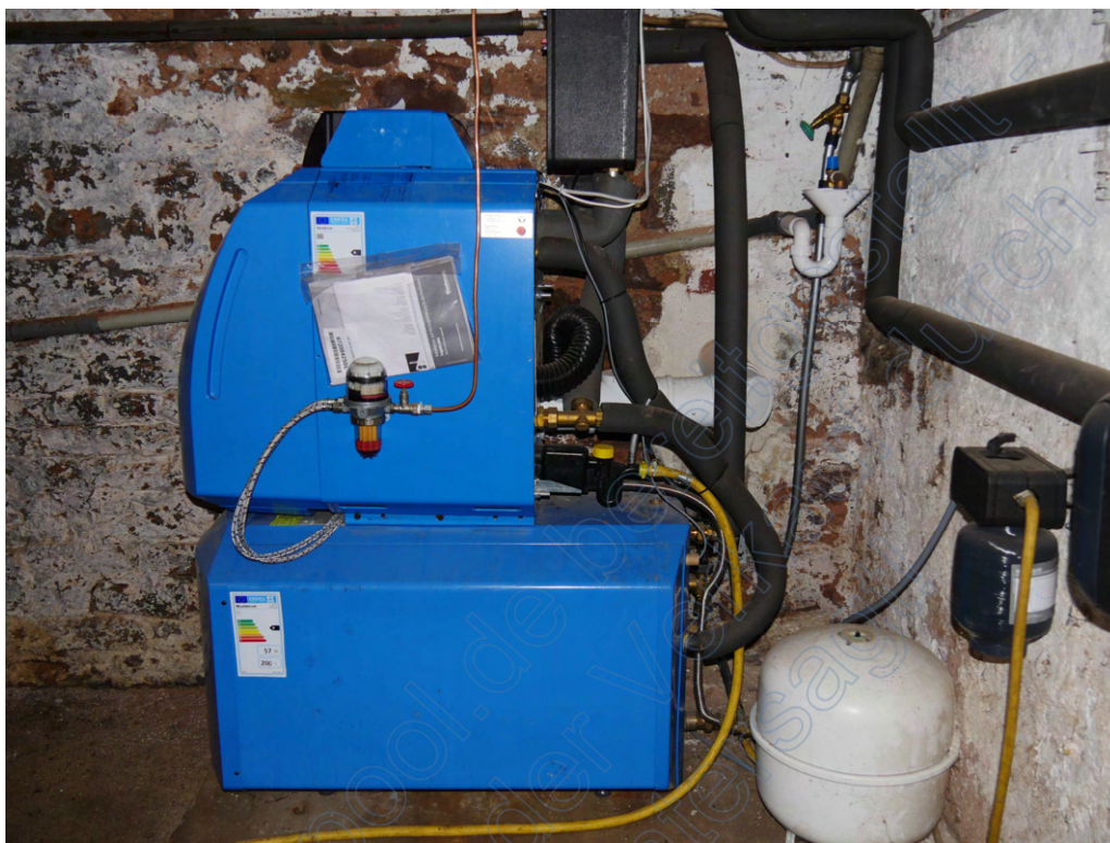
Bild 5: KG Wohnung 1 – Heizungsraum
