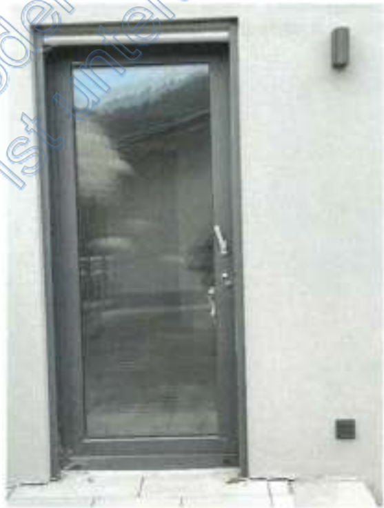
defekte Tür Souterrain
