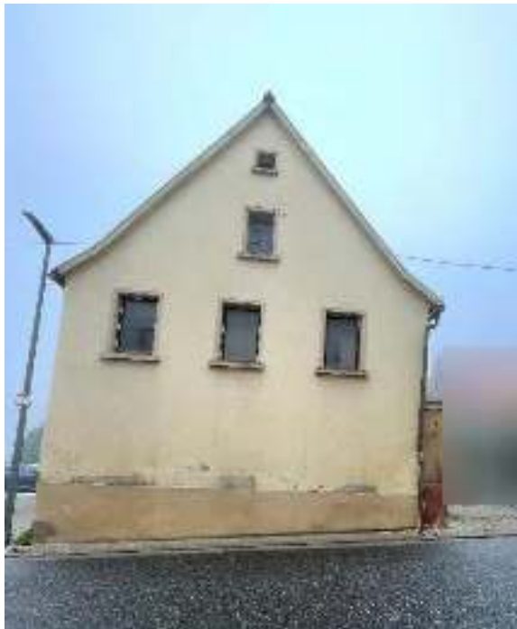
Straßenansicht, Regenfallrohr defekt
