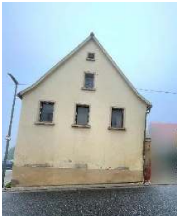
Straßenansicht, Regenfallrohr defekt
