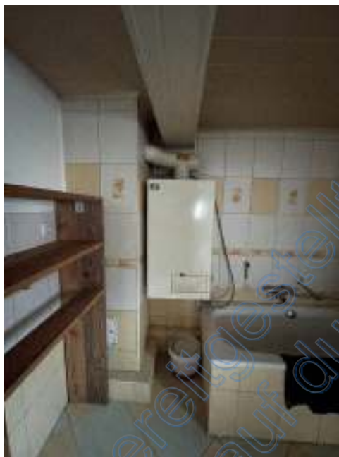
Heizungsanlage im Bad EG
