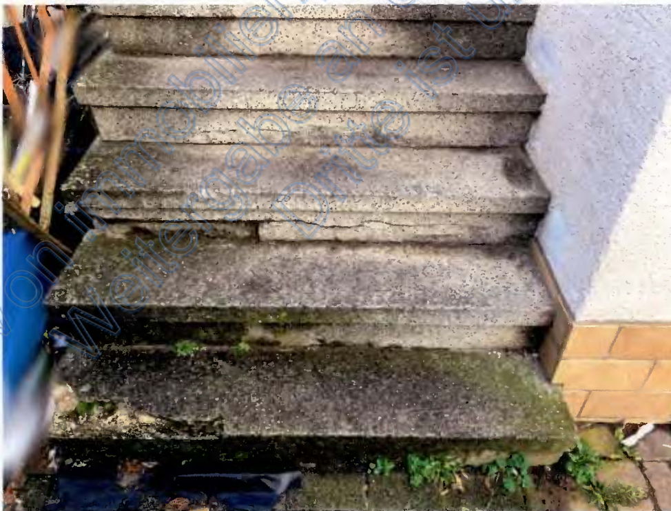
Detail Treppe; Schäden an Stufen
