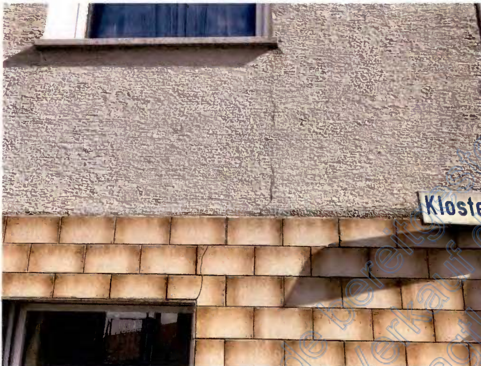
Detail Riss Westseite Klostergasse
