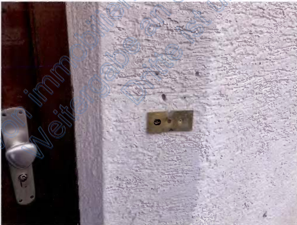
Detail Klingelanlage Wohnung EG; Defekt
