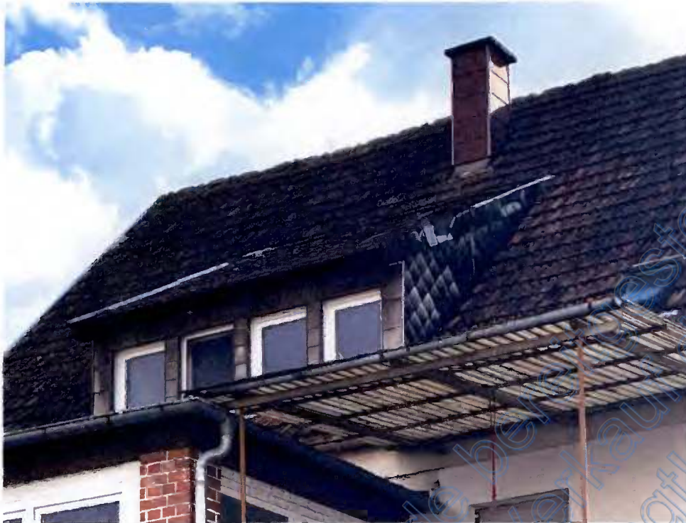
Detail Gaube Nordseite; fehlende Fassadenplatten; fehlende Ortgangbleche
