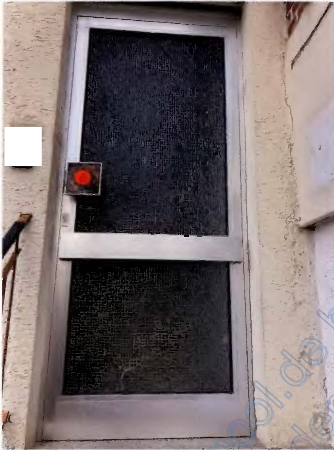
Detail Eingangstür Wohnung OG/DG; Glasbruch
