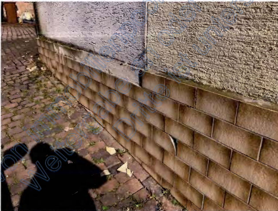
Detail Schäden am Sockel Kellergeschoss; Westseite Klostergasse
