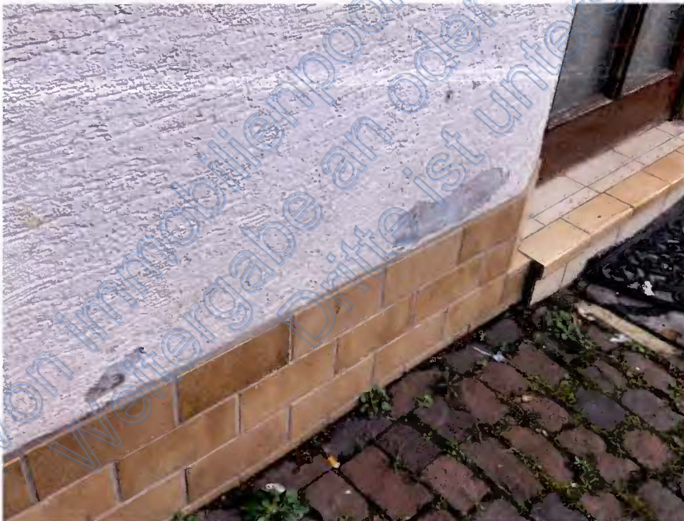
Detail Schäden Putz, Nordseite Hof, Zugang Wohnung Erdgeschoss
