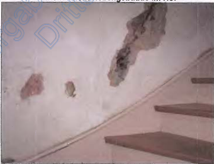
Schäden im Treppenaufgang Wohnhaus
