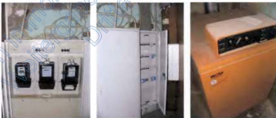
Wohnungseigentum / DG: Elektrosicherungskasten im DG und Zentralheizung im EG-Heizungsraum vom BWO
