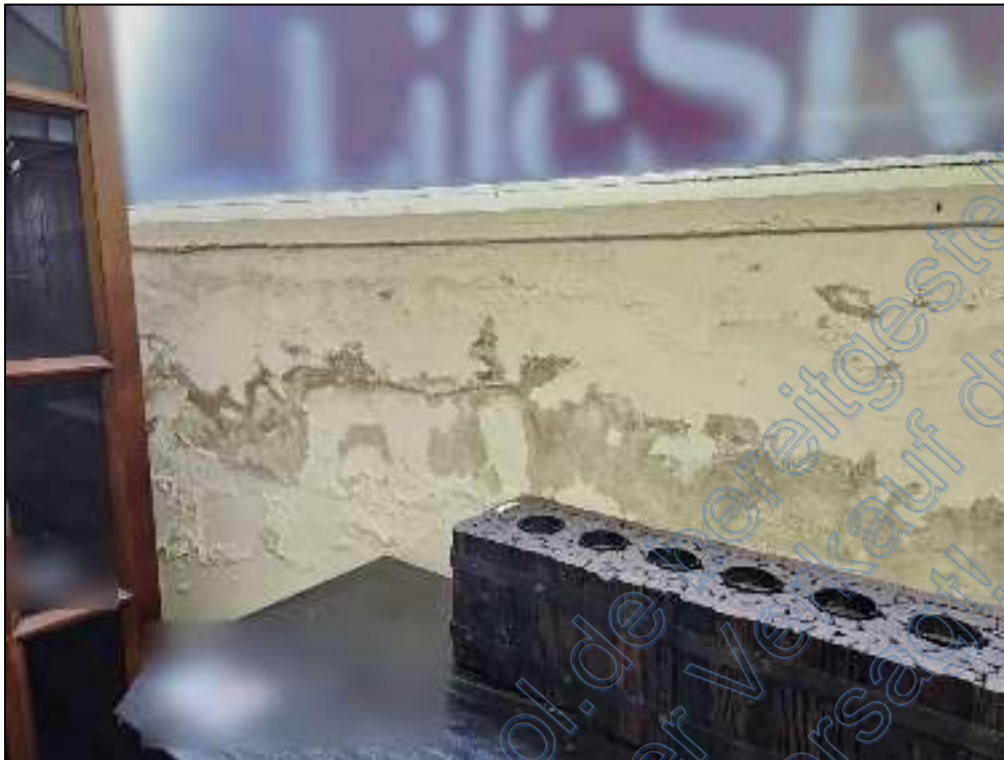
Feuchtigkeitsschäden Wand südliche Hallen
