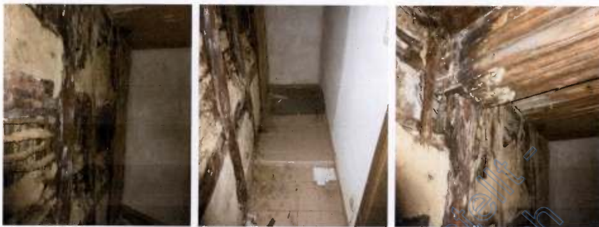
Bilder 6-8: Wohnhaus: EG: Eingangsflur/ Wasserschaden
