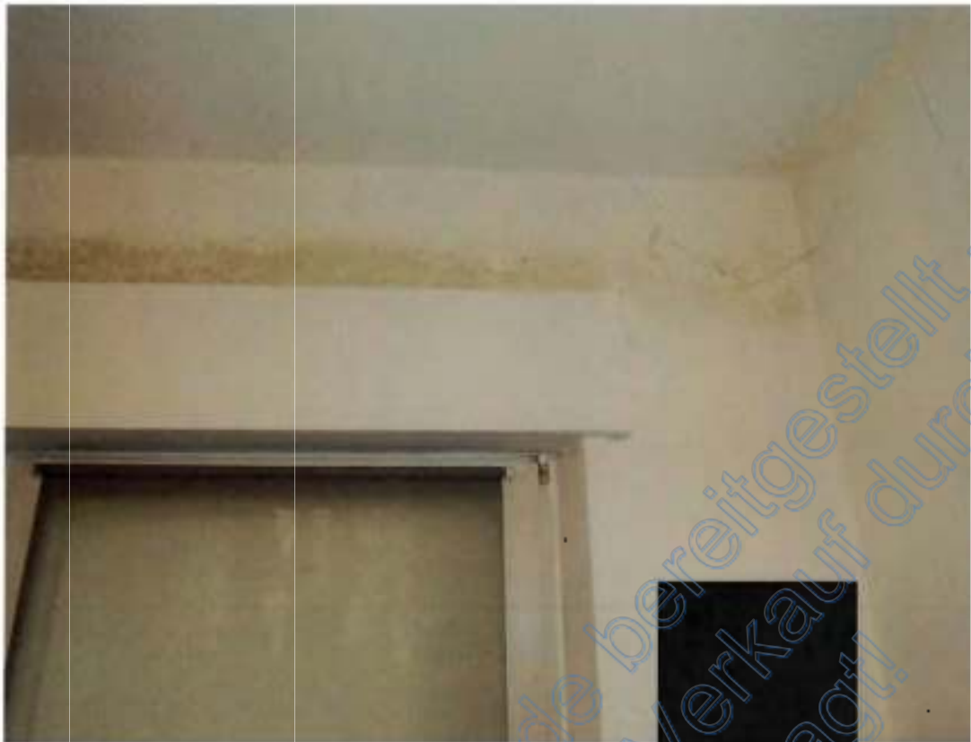
Wandbelag (Feuchtigkeit, Schimmelbildung)
