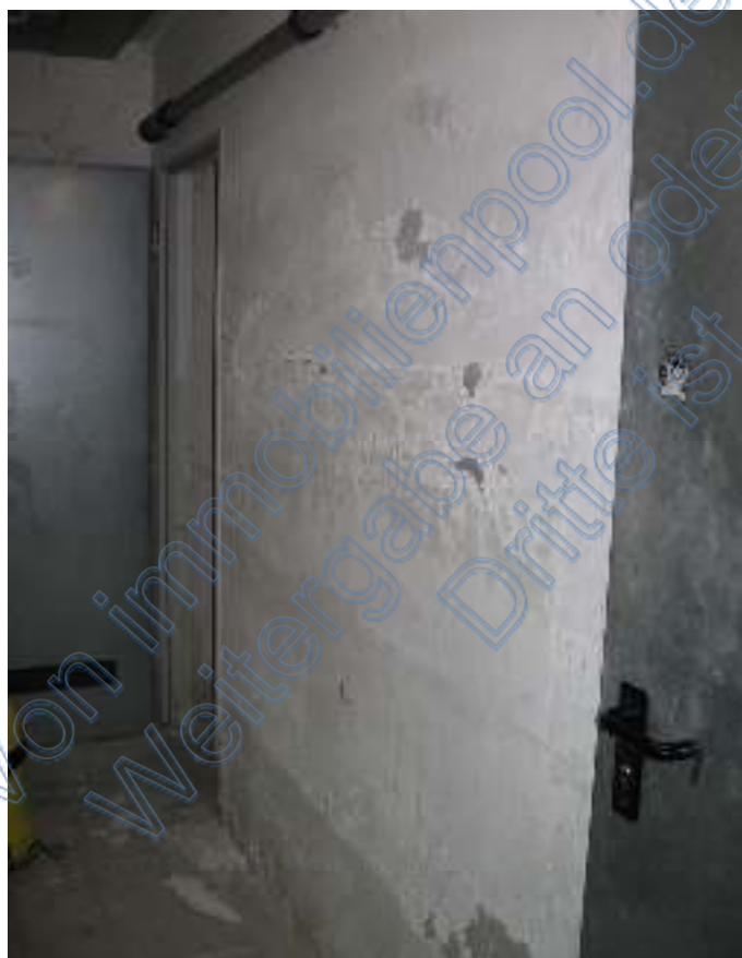
Abbildung 16: Aufsteigende Feuchtigkeit, erkennbar am Feuchtehorizont, an der Innenwand des Gemeinschaftskellers.
