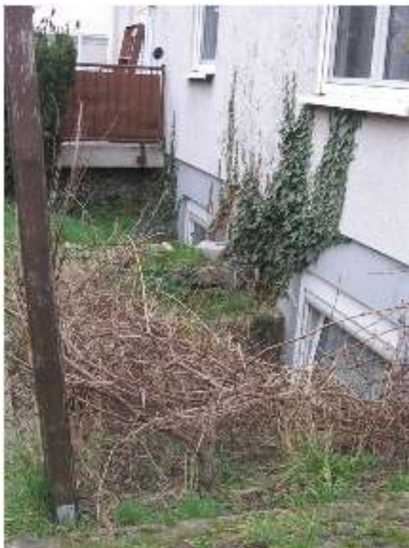
Abbildung 9: Fenster der Küche und des Wohnzimmers mit zugewucherten Lichtschächten.
