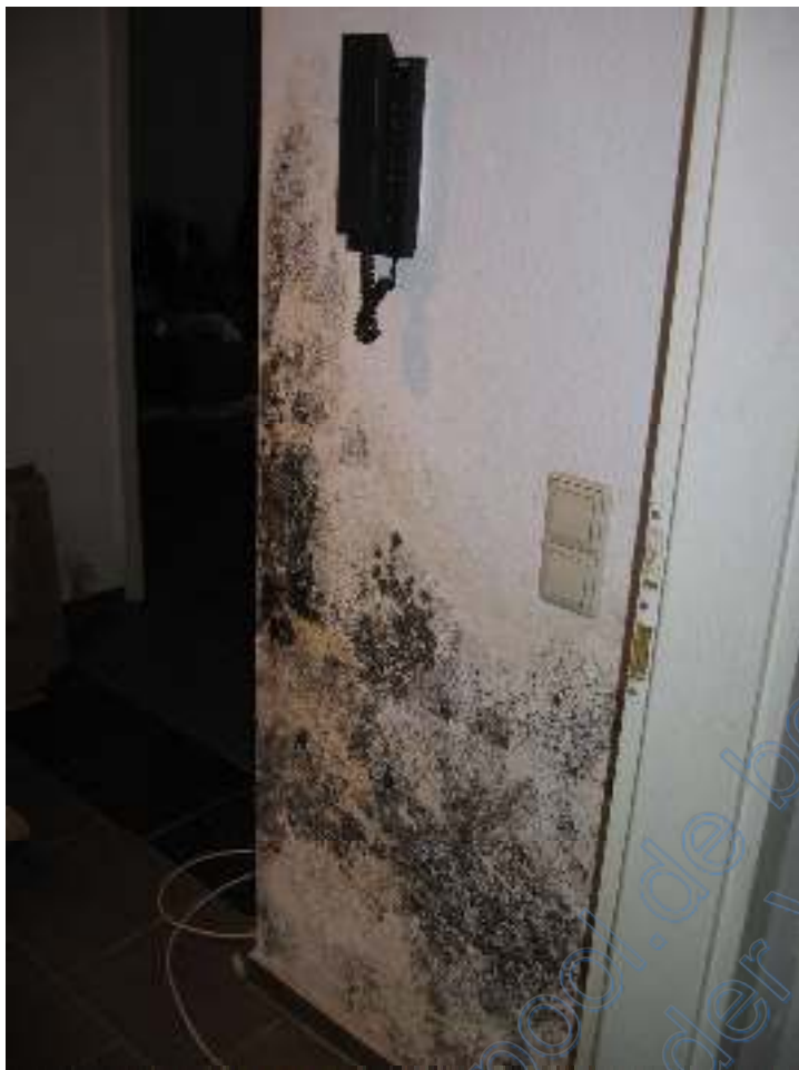
Abbildung 11: Flurbereich der Wohnung mit Schimmelbefall an der Innenwand / Wohnungstrennwand.
