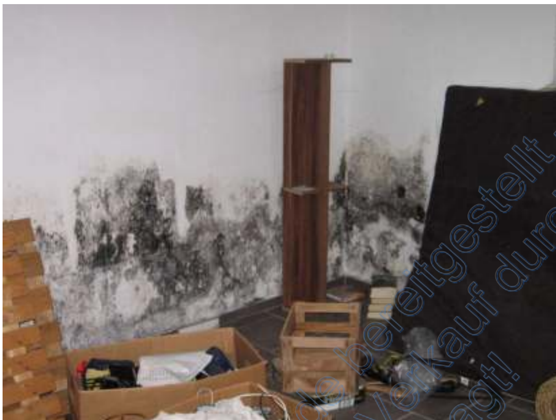
Abbildung 13: Schlafzimmer mit Schimmelbefall an den Außenwänden und Innenwänden.
