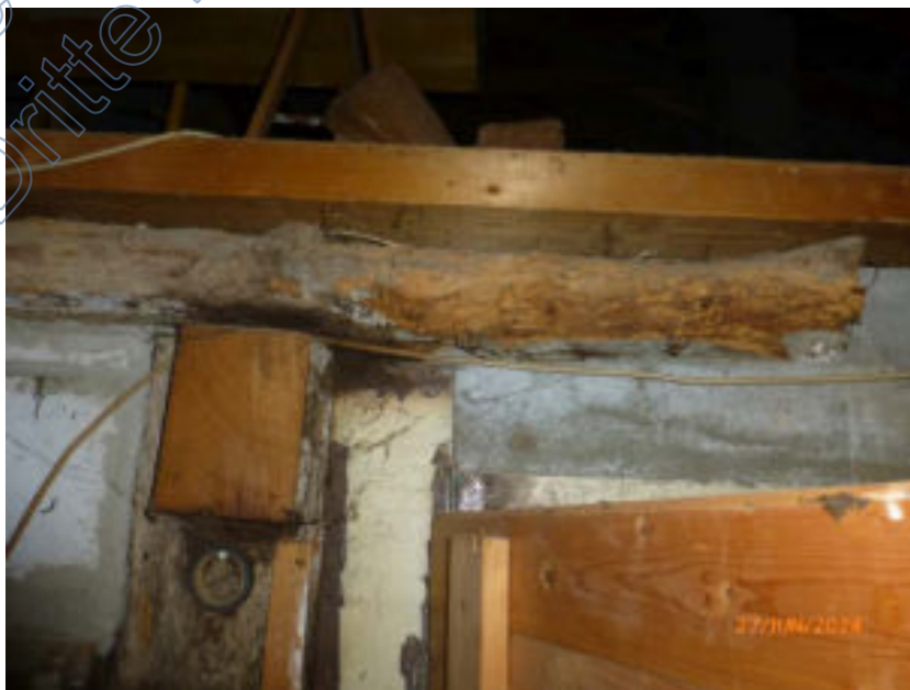
Holzschädlinge im Deckenbalken
