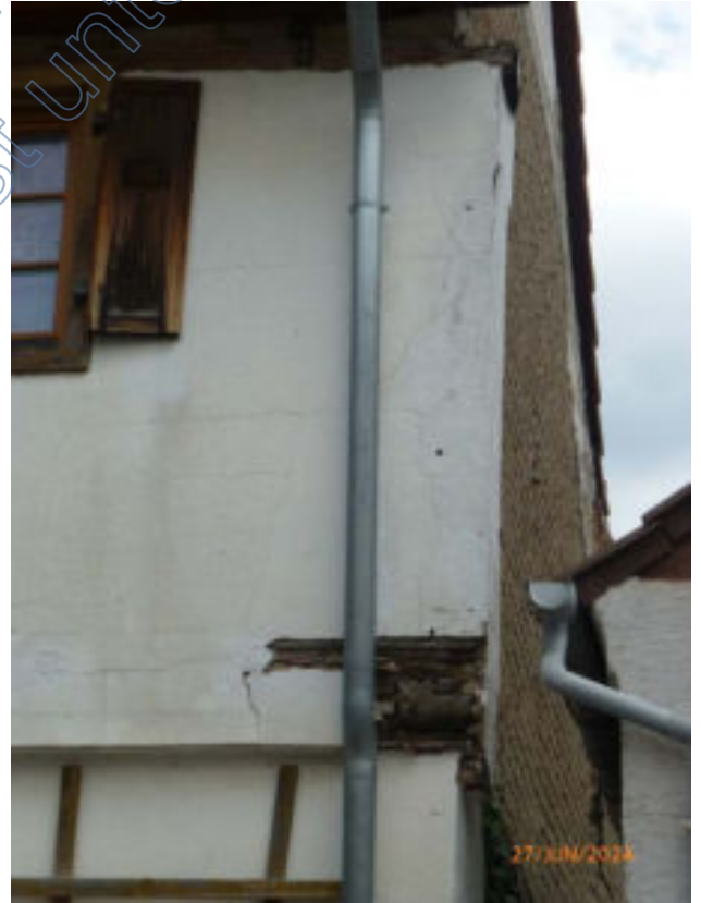
Fassade mit Rissen
