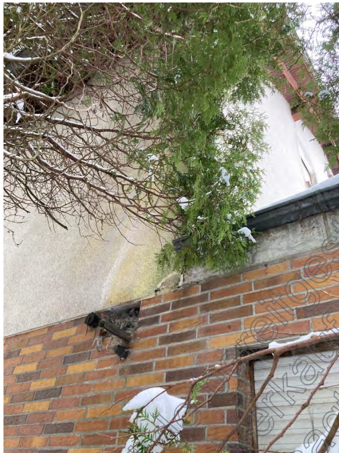
Bild 7 Ecke Wohnhaus / Garage (Ölstutzen)
