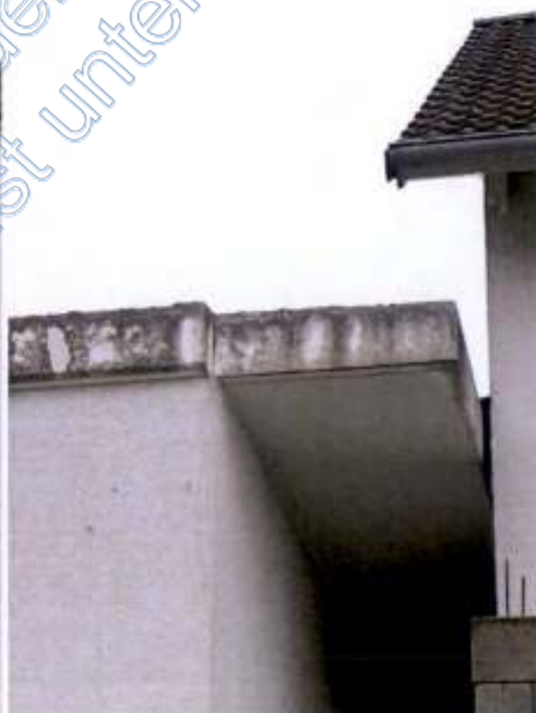
16 b schadhafter Dachüberstand
