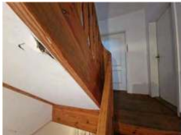
Bild 66 – Loch in der Treppe
