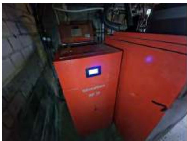
Bild 12 – Pelletheizung (nicht in Betrieb)
