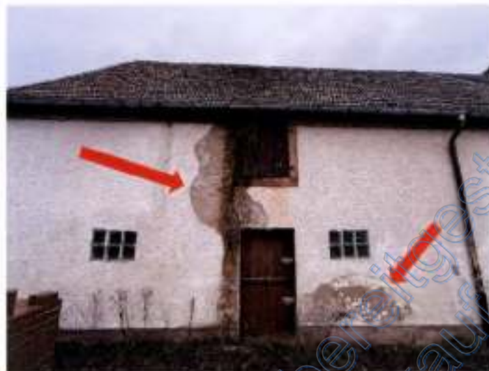
Bild 7: Scheunengebäude, Feuchteschäden an der Außenwand, Feuchteintritt durch mangelnde Dacheindeckung
