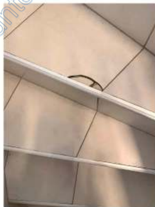
Treppe EG/KG beschädigte Fliese
