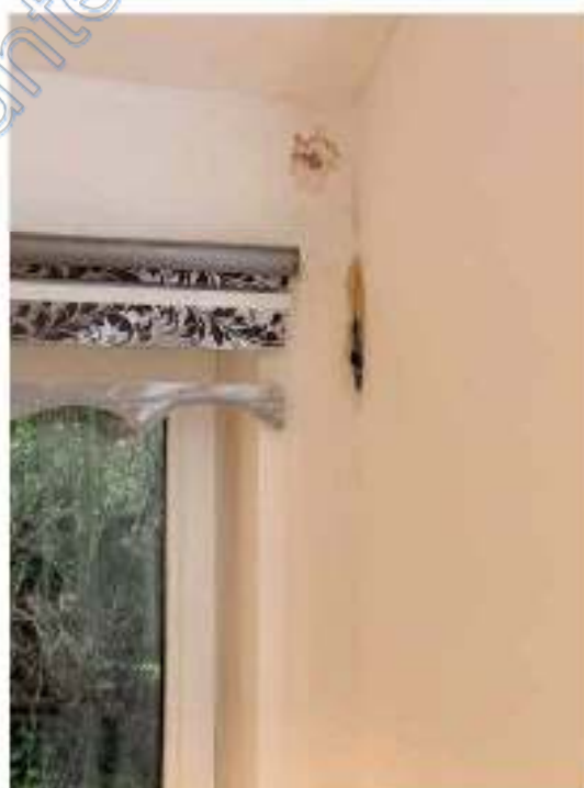
DG: Feuchtigkeitsspuren Außenwand Flur/Treppenaufgang
