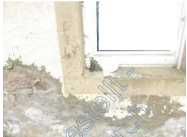
Bewuchs im Mauerwerk
