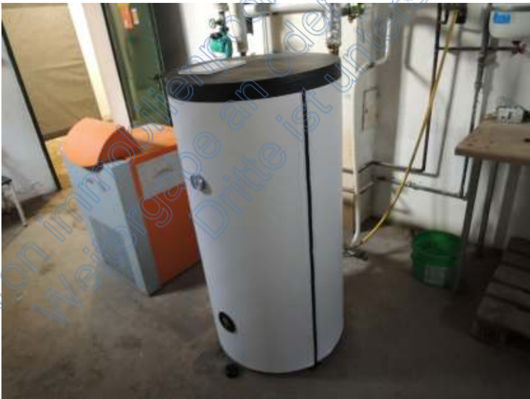
KG Zentralheizung in Haus 37 (Heizung in Haus 35 wurde nicht besichtigt)
