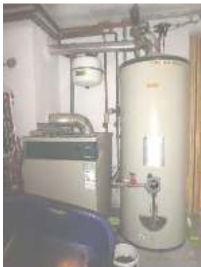
Heizung mit Warmwasserspeicher
