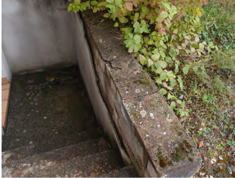
Bauschäden Außentreppe zu KG
