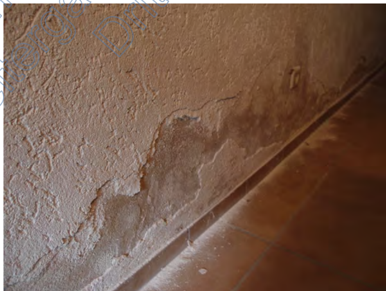
tlw. Putzablösungen KG, Bauschäden
