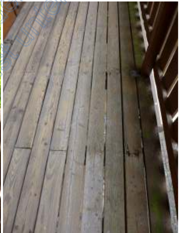
22 b tlw. schadhafte Dielen Balkon
