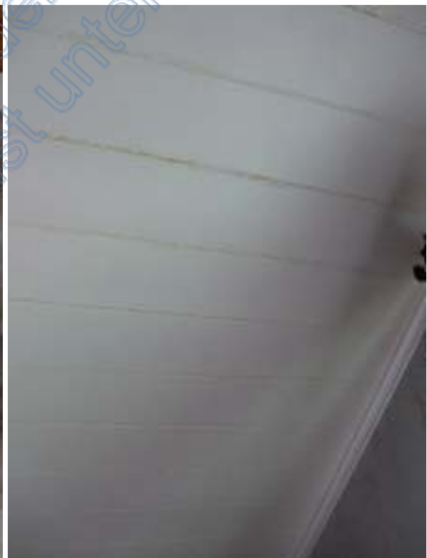
26 b Zustand Holzvertäfelung Bad DG
