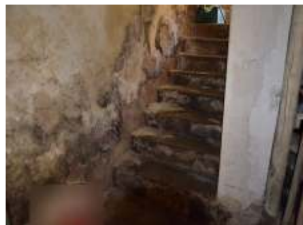
Putz- und Feuchtigkeitsschäden im KG
