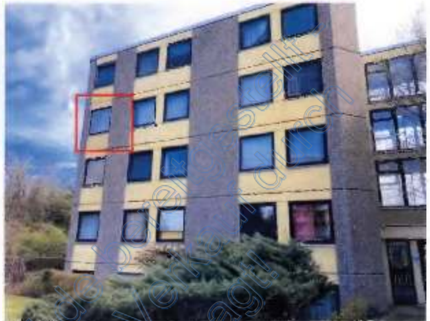
Foto 1 des SV: Wohnanlage Am Gonsenheimer Spieß 4, nördlicher Gebäudeteil, Ansicht von Westen; Detail Wohnung Nr. U 1; Roteintragung d.d. SV
