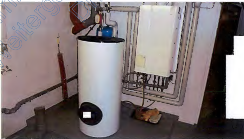
Gastherme und Warmwasserspeicher im KG
