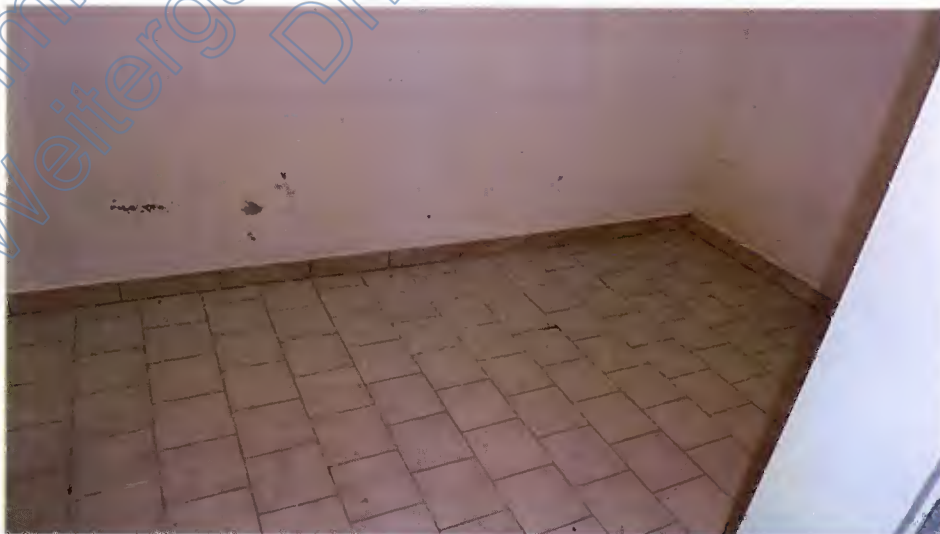
Feuchtigkeitsschäden im Kellersockelbereich
