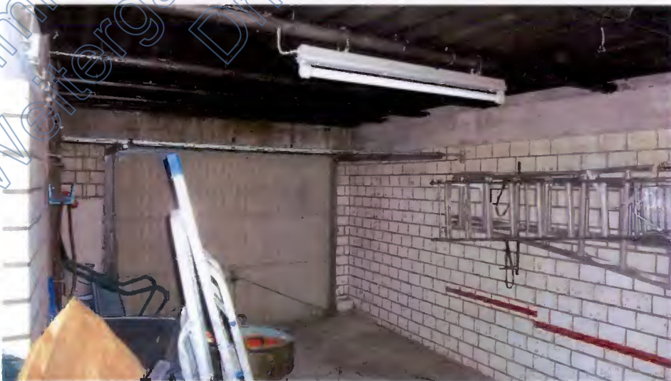
Garage Innenraum mit Feuchtespur am Ringanker
