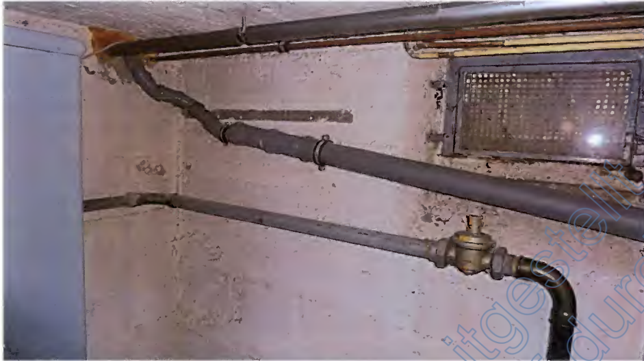
Leitungsführungen im KG
