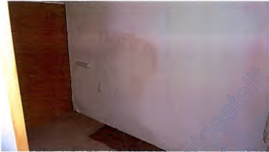
sehr kl. Zimmer EG (Abstellr.) mit Feuchtespuren im Wandbereich
