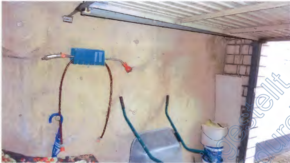
Feuchtschaden Wandbereich in der Garage
