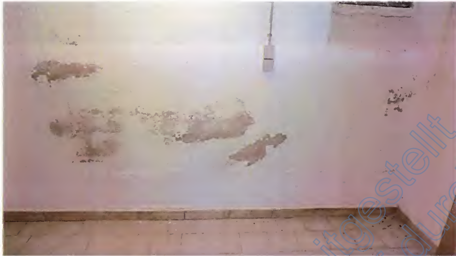
Feuchtigkeitsschäden Sockel-/Wandbereich im KG
