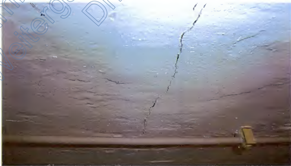
partielle Rissbildung Deckenbereich KG
