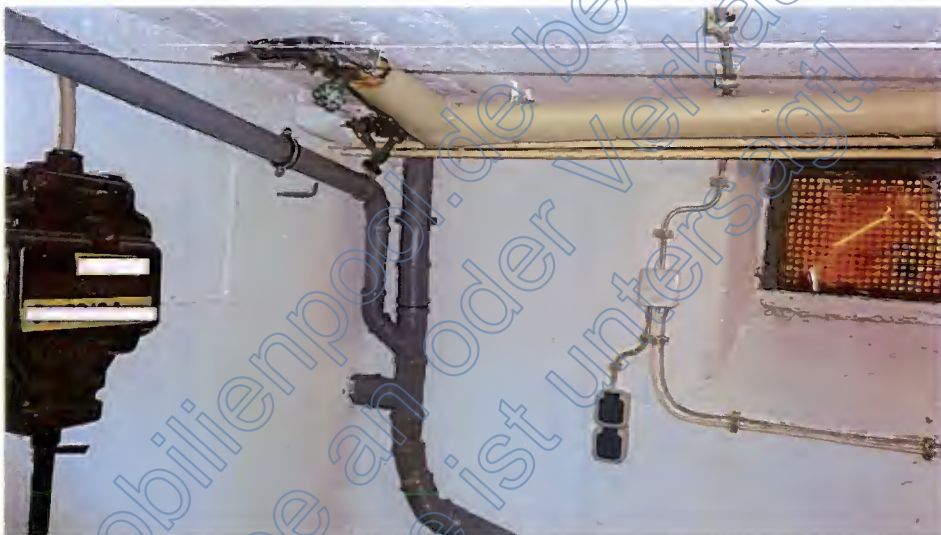
Leitungsführungen im KG
