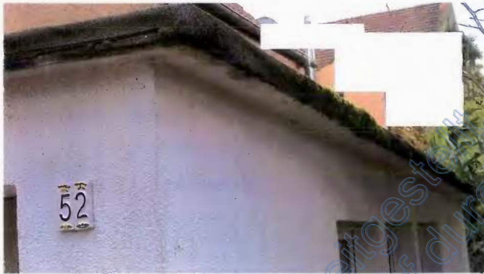
Dachrandbereich Garage mit vermoosten Feuchteschäden
