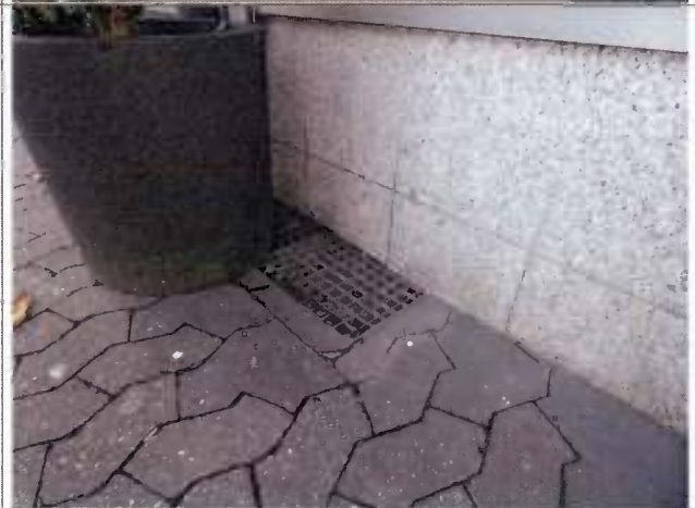
Pflaster hat Gefälle zum Haus (lt. HV kam es bei Starkregen schon zu Wassereinbruch im Keller)
