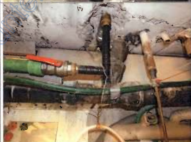
KG Heizraum: Leitungen korrodiert, Durchbrüche nicht verschlossen
