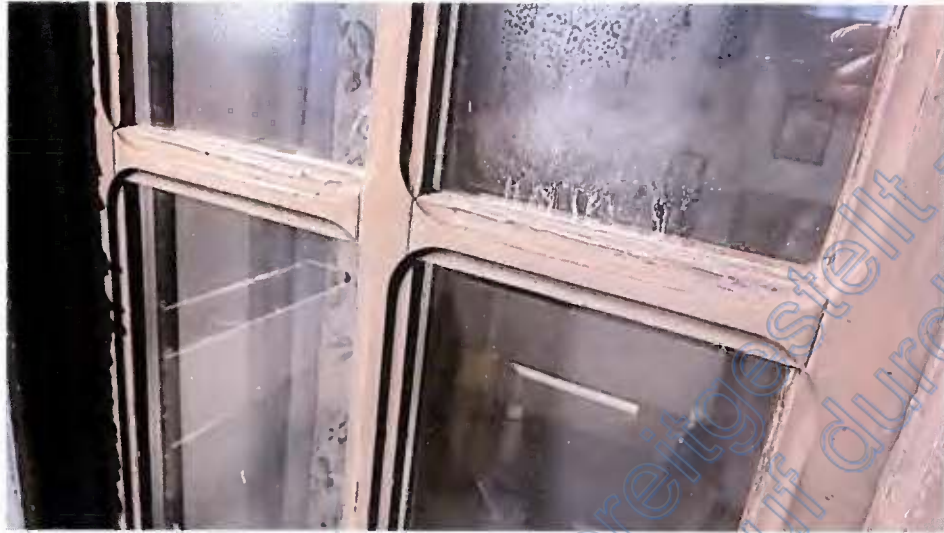
Holzfenster tlw. mit Abnutz.ersch. / tlw. Anstrich erforderlich
