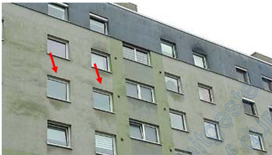
ungefähre Lage der Wohnung Nr. 27 im 5.OG (insg. erheb. Saugwirkung des Fassadenputzes bei Regenfällen / partiell dunkle Flecken)
