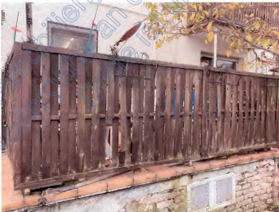
Bild 6: Blick auf den schadhaften Zaun (Freisitz Wohnhaus 1)
