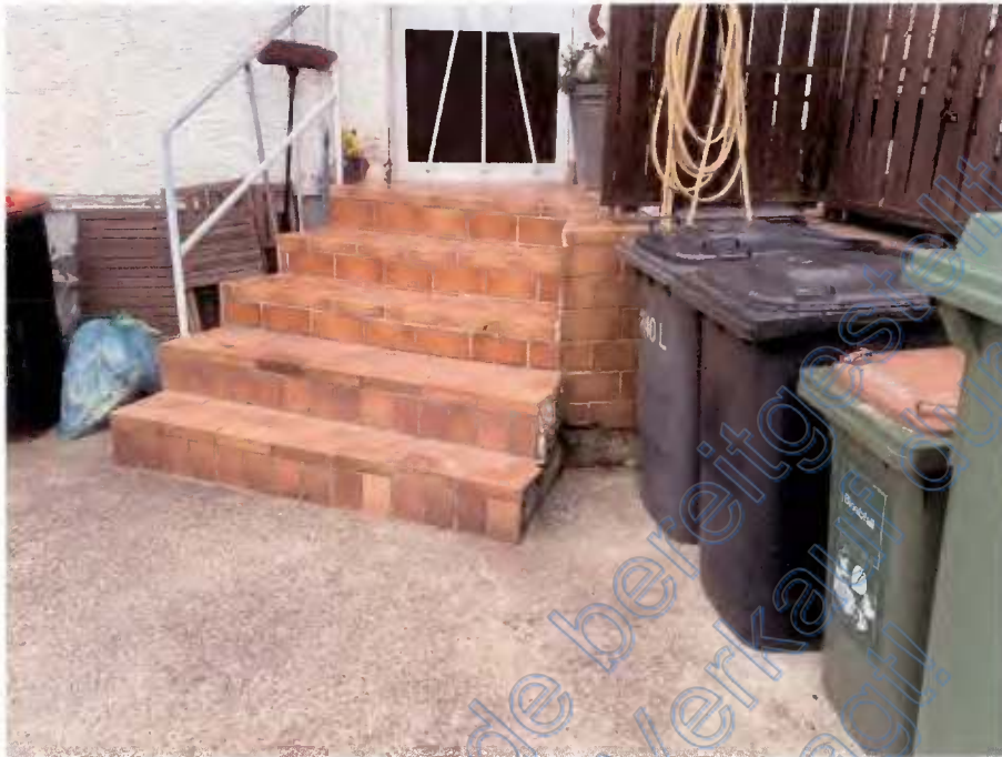
Bild 5: Blick auf die Eingangstreppe mit schadhaftem Fliesenbelag
