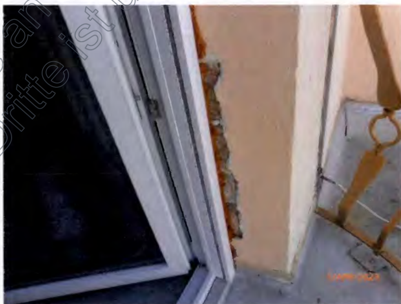
Unterhaltungsstau Balkontür DG
