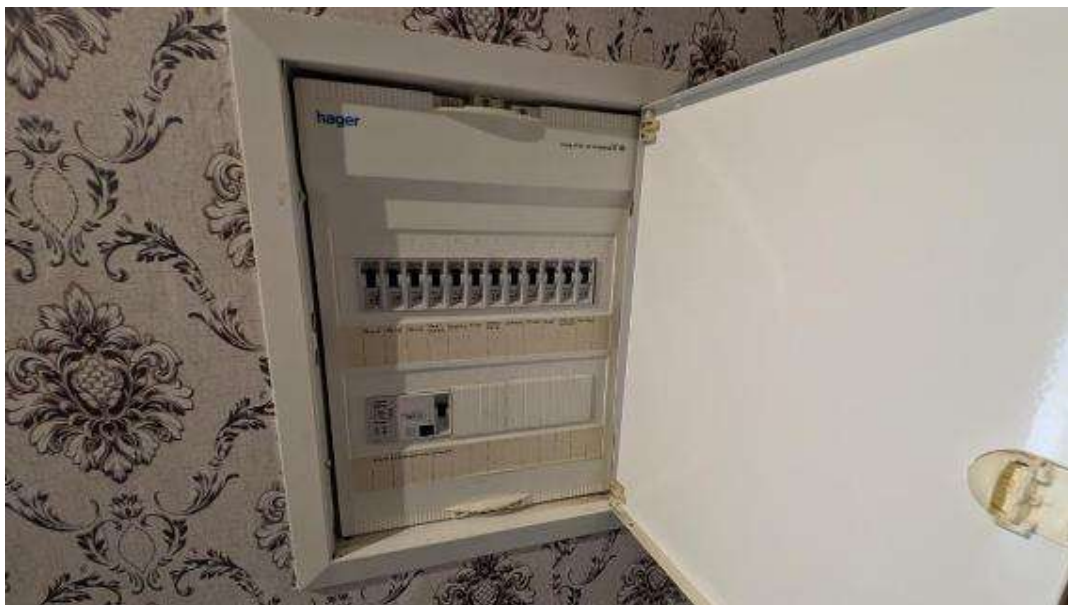
Bild C1 Beispiel Haustechnik Mehrfamilienhaus
