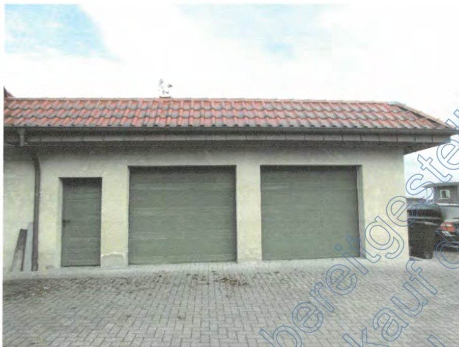
Foto 19: PKW-Doppelgarage, stumpfe Lackierung der Tore und Tür, fehlender Endanstrich
