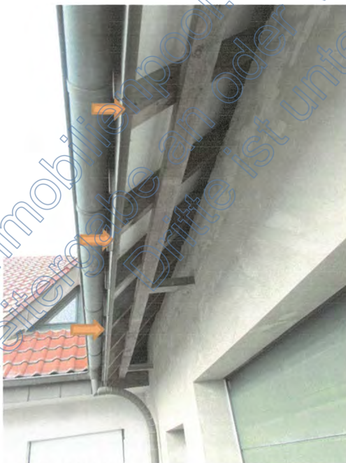
Foto 20: PKW-Doppelgarage, fehlende Verkleidung an der Untersicht des Dachüberstandes
