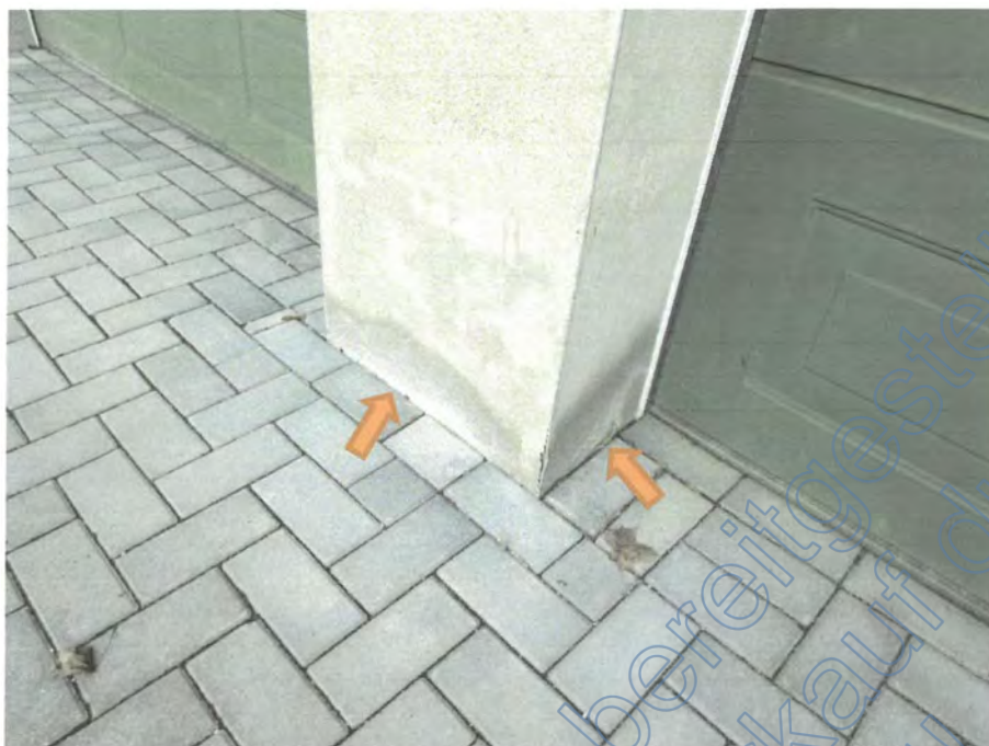
Foto 17: PKW-Doppelgarage, Feuchtigkeit im Sockelbereich
