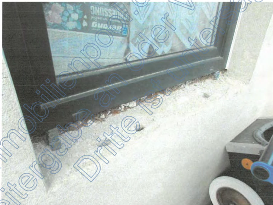
Foto 16: PKW-Doppelgarage, fehlende Fensterbänke
