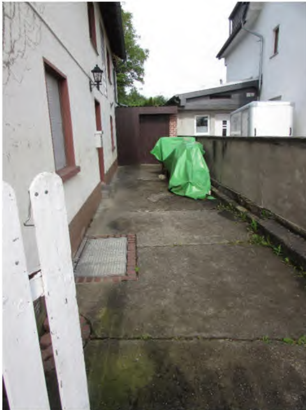
Foto 11: Zugang: verwitterte/schadhafte Betonbefestigung; hinten: Abstellraum-Anbau
