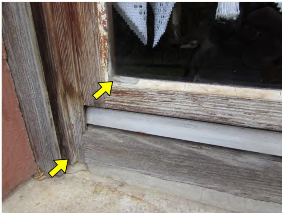
Foto 8: Wohnhaus: überalterte, verwitterte Holzfenster, schadhafter Fensterkitt
