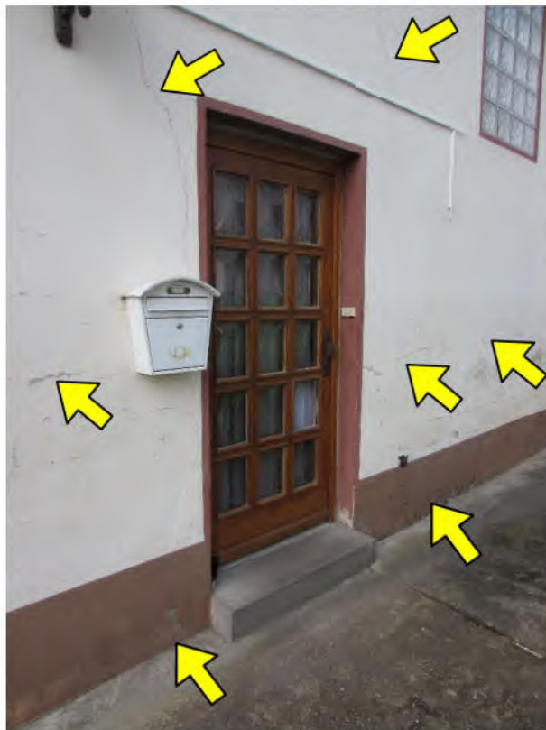
Foto 2: Wohnhaus, Hauseingang: Risse im Fassadenbereich, abblättrener Farbanstrich
