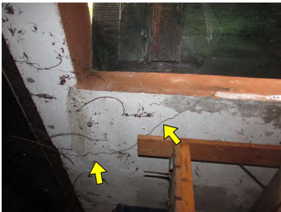
Foto 16: Nebengebäude: Risse im Wandbereich
