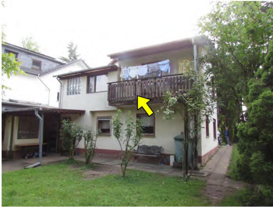
Foto 3: Wohnhaus, rückwärtige/West-Ansicht: verwittertes Balkongeländer
