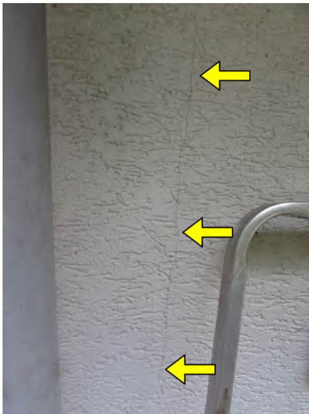
Foto 8: Wohnhaus: Risse in der Fassade
