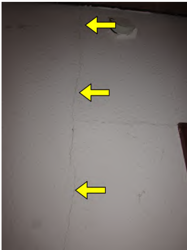
Foto 12: Erdgeschoss: Risse im Innenwandbereich
