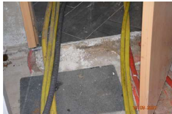
Übergang des Betonbodens im Technikraum zu dem gefliesten Boden der anderen Keller-räume
