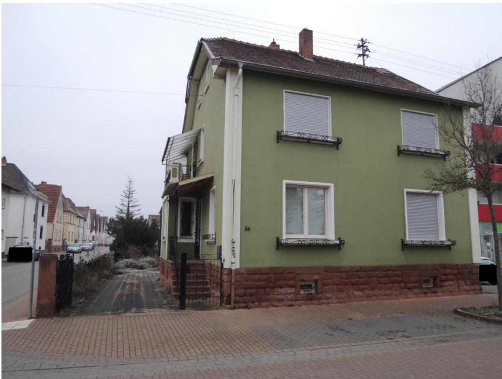
Sockel (Sandstein) mit offensichtlicher Feuchtigkeitseinwirkung
