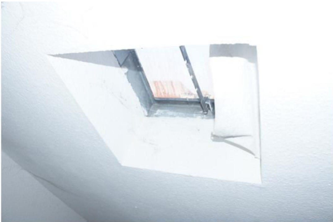
Bild-Nr. 44: Einfachverglastes Dachflächenfenster
