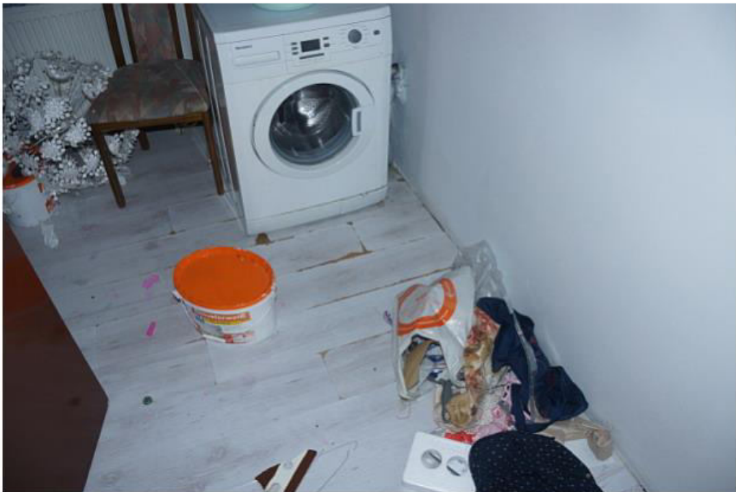
Bild-Nr. 38: Defekter Boden
