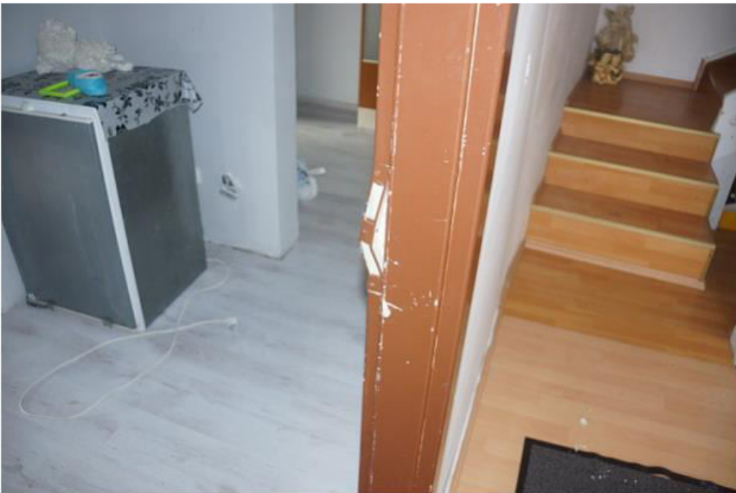
Bild-Nr. 36: Defektes Türschloss
