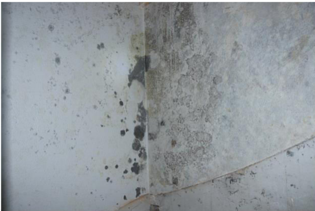
Bild-Nr. 34: Schimmel an Kellertreppeneand
