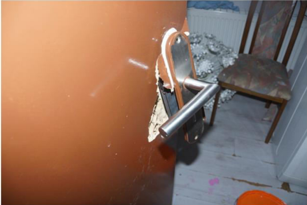
Bild-Nr. 37: Defekte Tür
