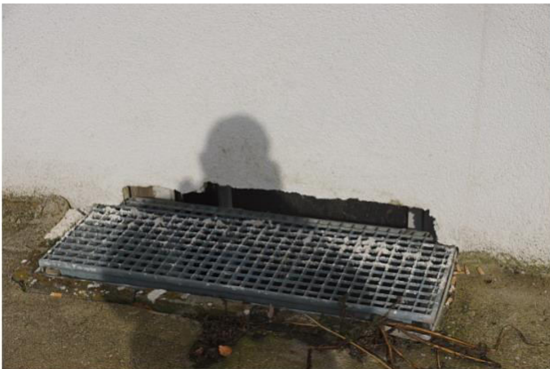
Bild-Nr. 32: Dämmung nicht fertiggestellt am Kellerfenster
