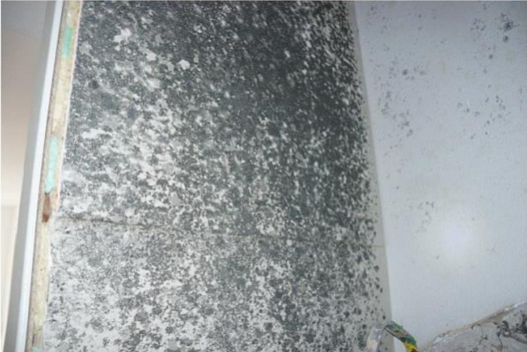
Bild-Nr. 35: Schimmel an Kellertreppeneand
