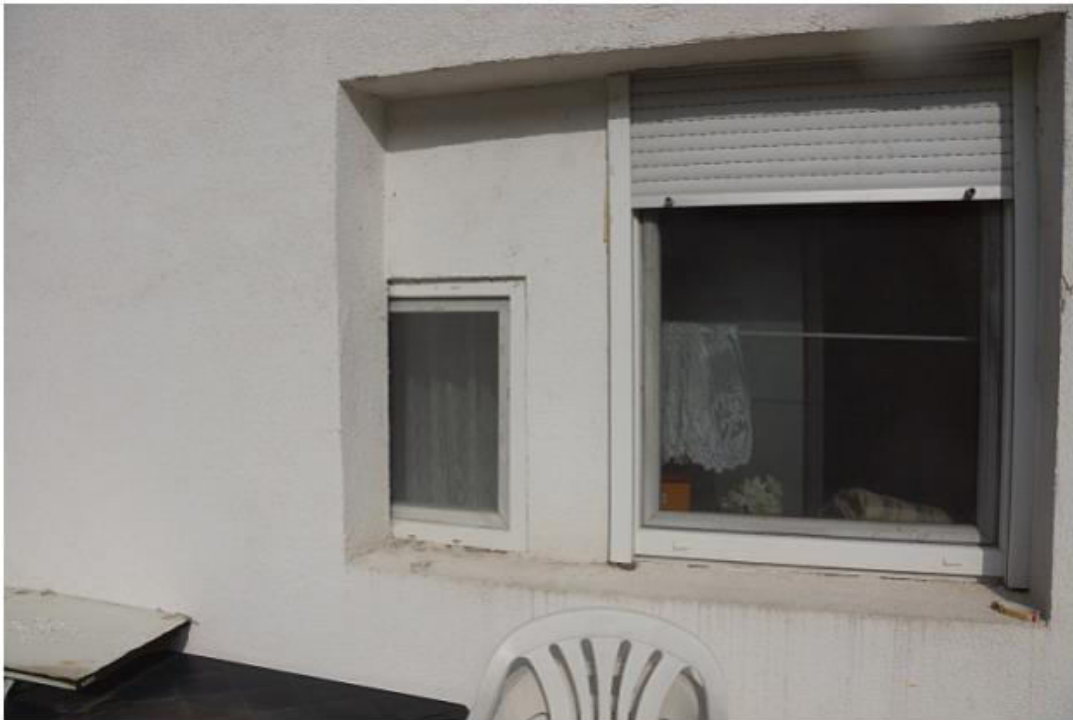
Bild-Nr. 33: Dämmung über Zimmerfenster
