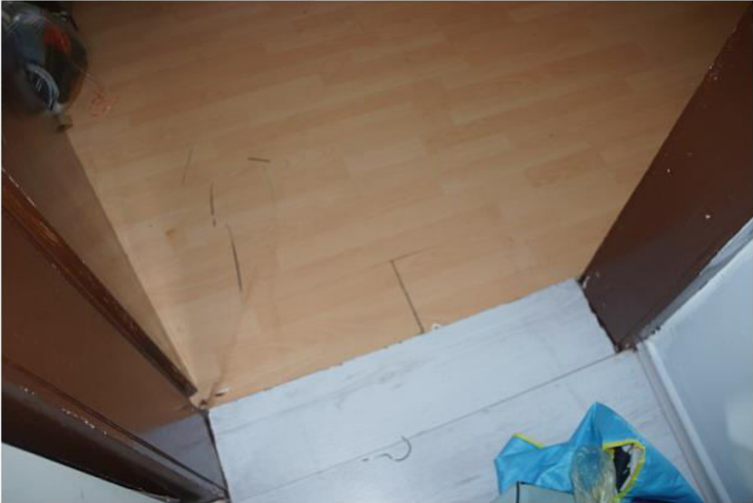
Bild-Nr. 39: verschobener Laminatboden
