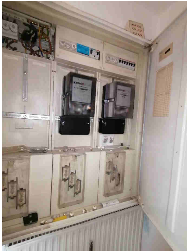
Aufnahme 7: Stromzähler (für beide WEG)
