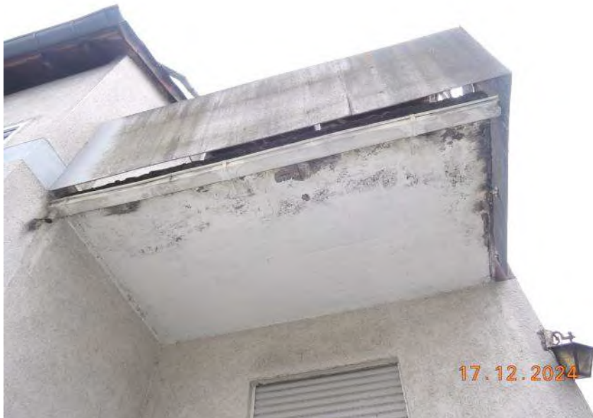
Abb. 26: Feuchtigkeitsschäden am hofseitigen Balkon
