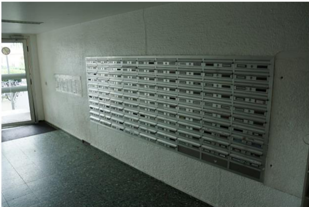
Bild-Nr. 6: Briefkasten- und Klingelanlage
