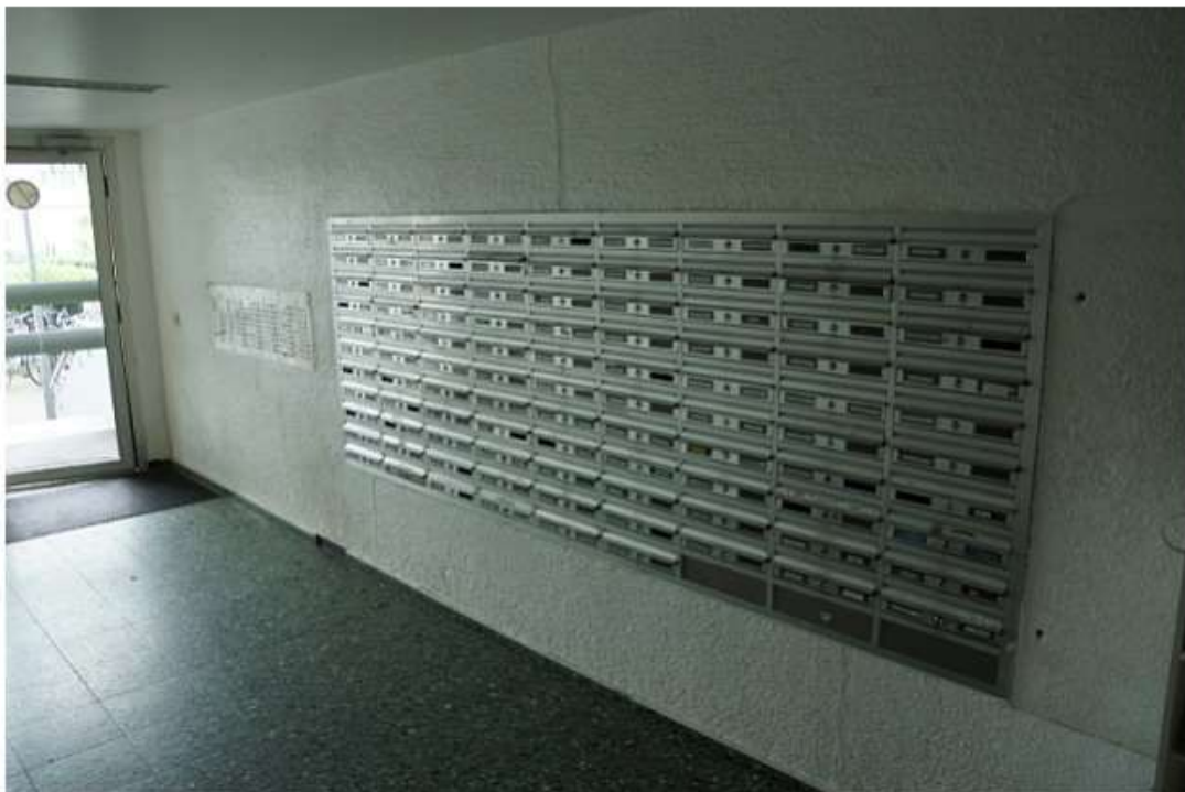
Bild-Nr. 6: Briefkasten- und Klingelanlage
