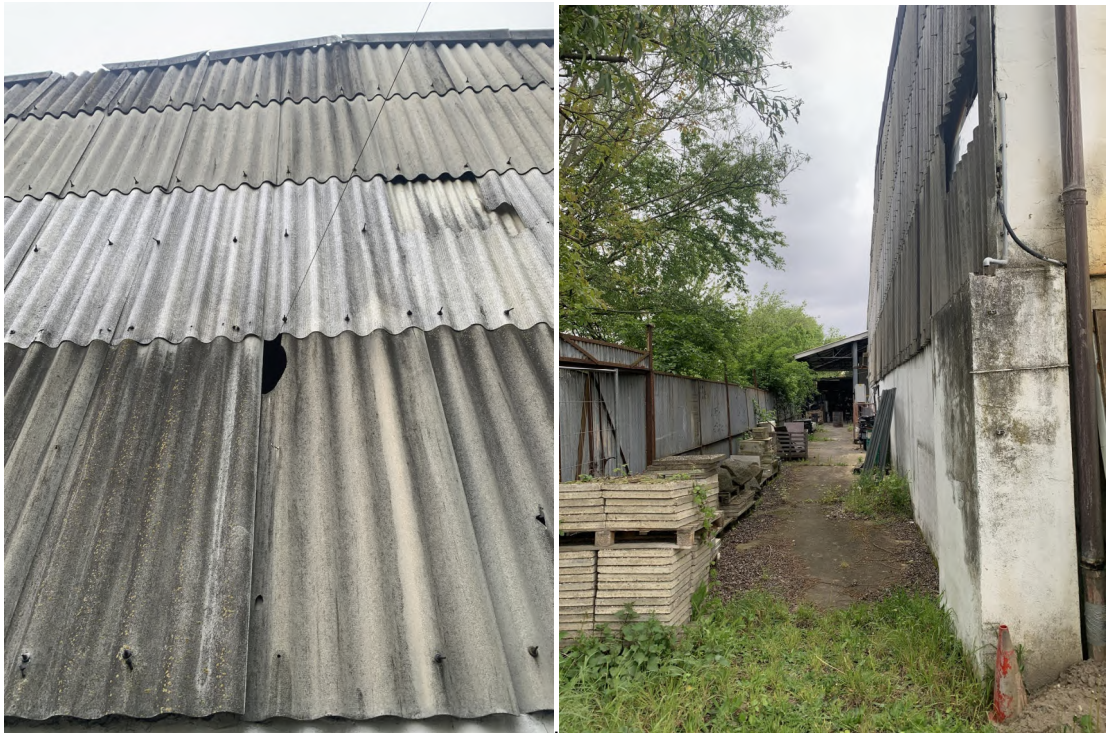
Schäden an der Außenhülle
