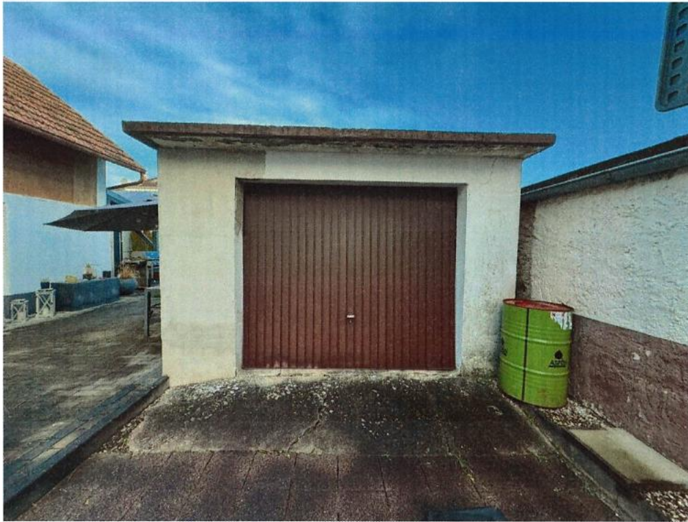
Garage (Schäden und Feuchtigkeit ersichtlich)
