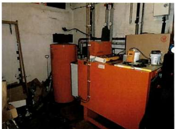
Öl-Heizung im Keller
