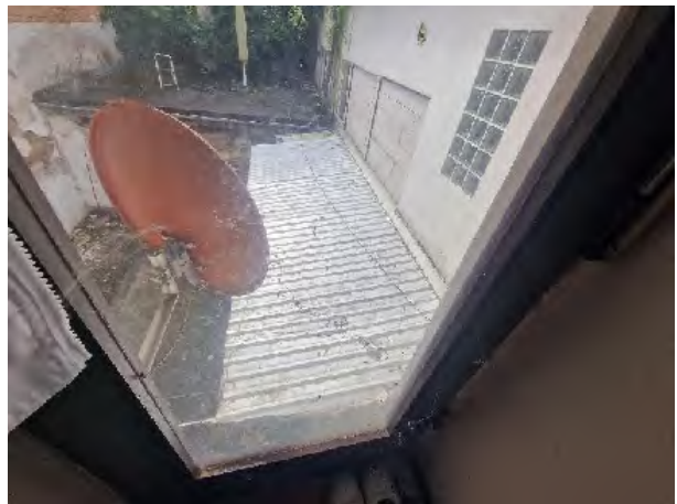
Bild 52 – Balkontür ins Nichts – akute Absturzgefahr
