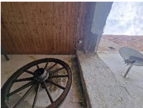
Bild 45 – Weitere Auswirkungen der Feuchtigkeit
