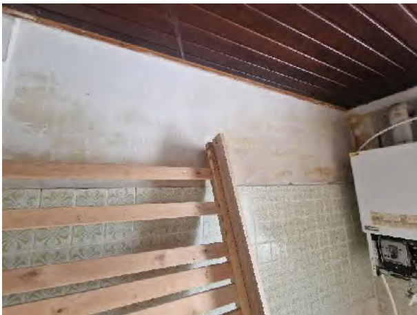
Bild 51 – Feuchteschaden Bad und defekte Heizung
