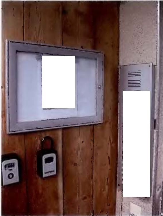
Blick auf die Klingelanlage im Hauseingangsbereich
