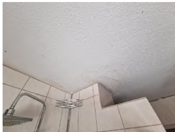
Bild 42 – Feuchtigkeitsrückstände Decke Bad OG
