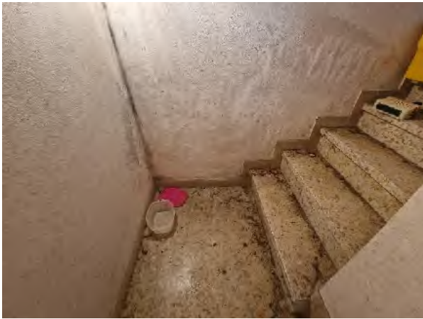
Bild 37 – Feuchtigkeitschaden Außenwand Keller
