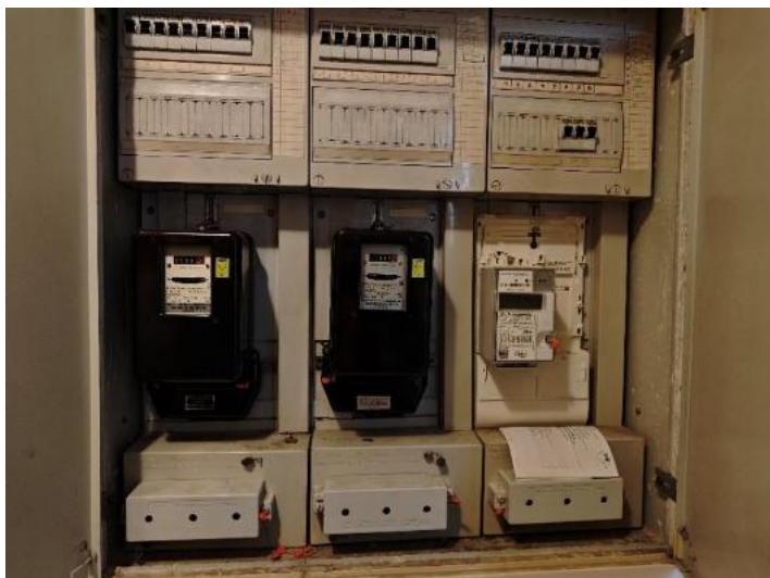
Zählerkasten im Flur
